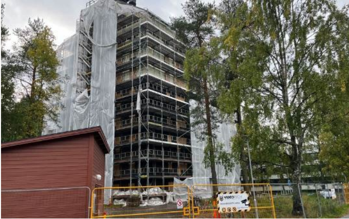
Luleå: Brandskadade flerfamiljshuset ska inte rivas
