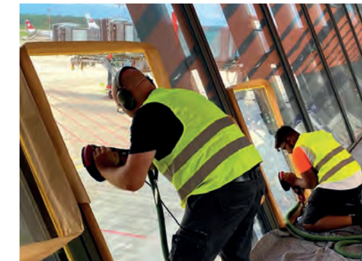
The Circle – Flughafen Zürich: Dutzende Oberflächenschäden und Glaskratzer wurden vor der Übergabe entfernt, ohne die Glasscheiben kostspielig und aufwendig auszutauschen.
