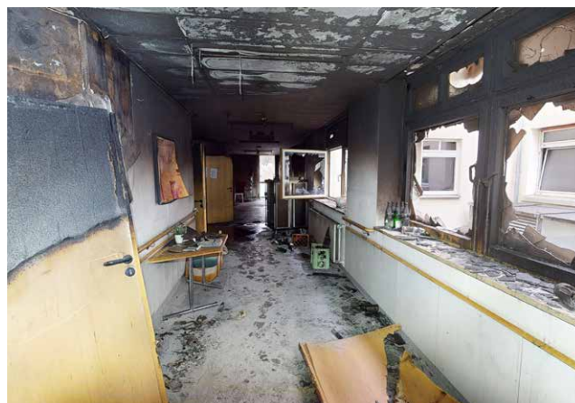
Die Folgen des verheerenden Brandes im Krankenhaus.
