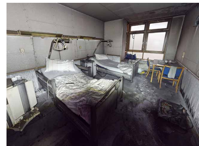
Feuer und Löscharbeiten beschädigten zahlreiche Zimmer.
