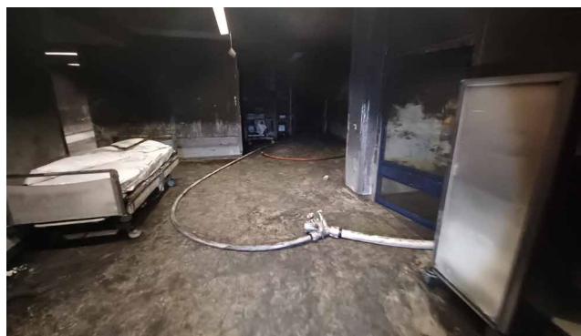
Bei der Erstbesichtigung wird das Ausmaß des Brandschadens deutlich.
